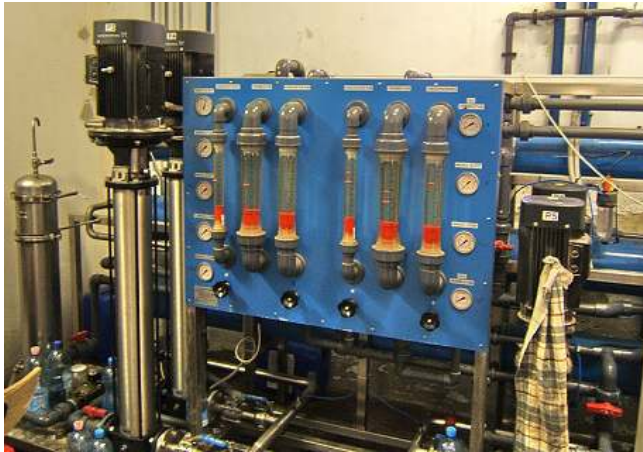
Fordított ozmózis (RO) berendezés a víz sótalanításához
