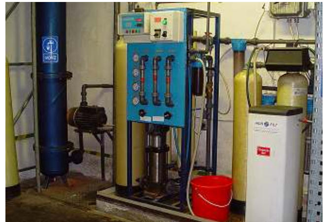
Kétlépcsős vízlágyító berendezés (RO + utólagító)
