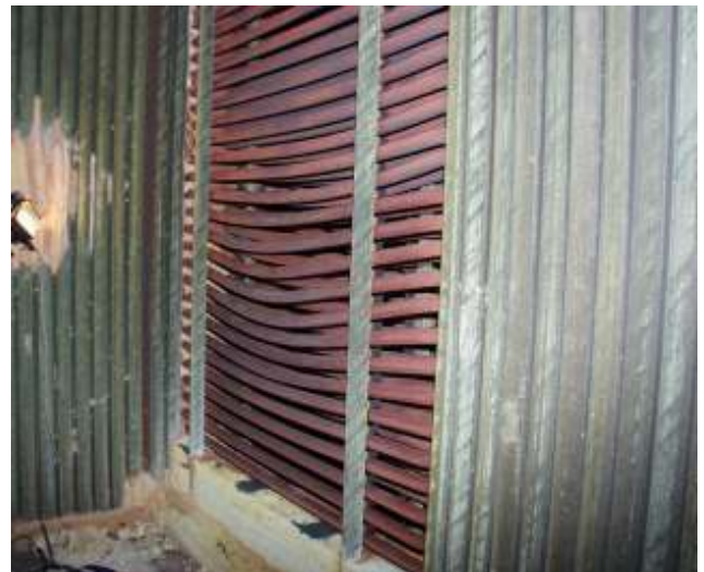
9. ábra. Túlhevülés miatt alakváltozott kazáncsővek Fig. 9: Deformed boiler's tubes caused by overheat
