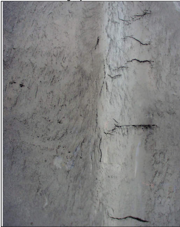
11. ábra – Repedések egy gőzvezeték hegesztési varratában (N ≈ 1x) Fig. 11. – Cracks in the weld of a steam pipe (M ≈ 1x)
