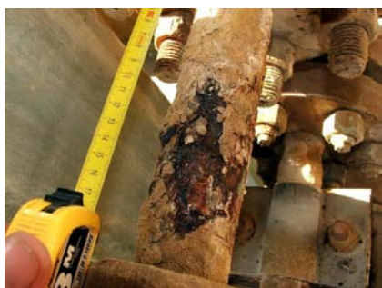
13. ábra: Korrozíós fagyások a fokozatközi hűtőnél
