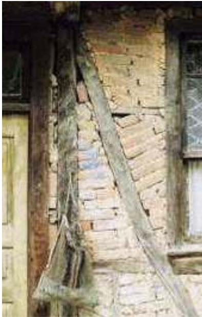
2. ábra. Egy hagyományos épület részlete a földrengéses vidék szívében, Golcuk, Törökország, 1999 októberében. A fotót 1999-ben Randolph Langenbach készítette: ( http://conservationtech.com/ , http://traditional-is-modern.net ) és szíves engedélyével közöljük.
